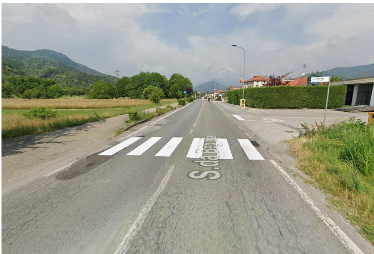
Figura 4 - Sede stradale con cedimenti laterali e pavimentazione usurata
