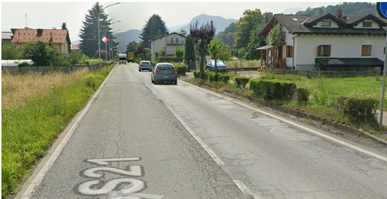
Figura 5 - Sede stradale con cedimenti laterali e pavimentazione usurata
