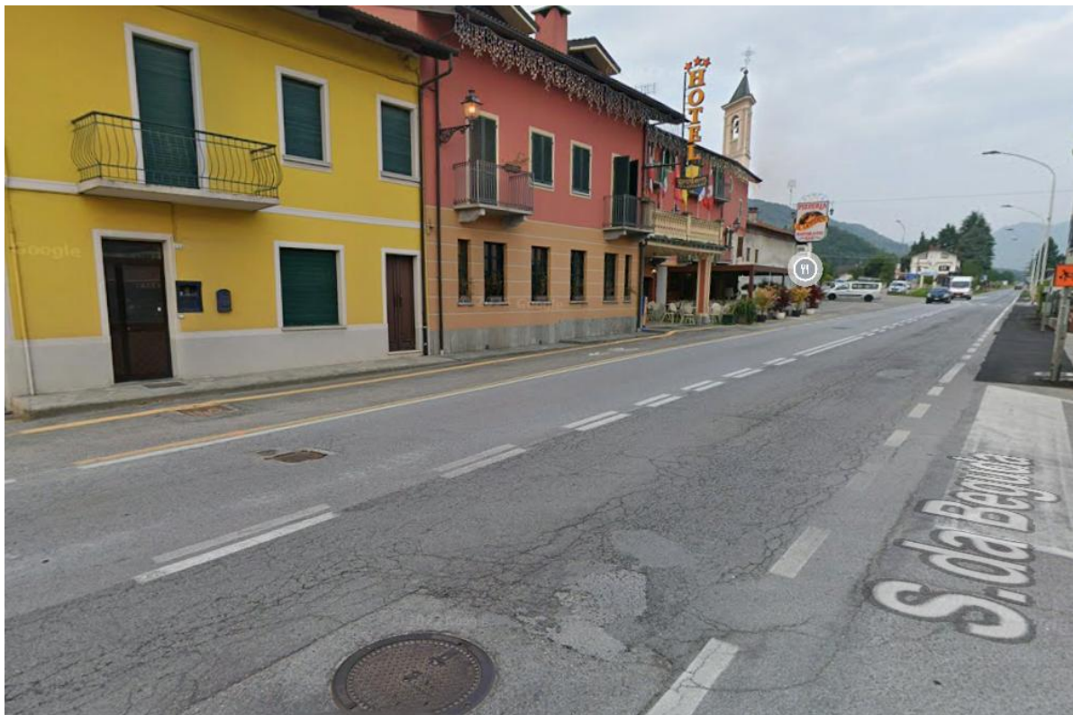
Figura 1 – Via Beguda – zona incrocio strada per Roccasparvera – pavimentazione stradale danneggiata
